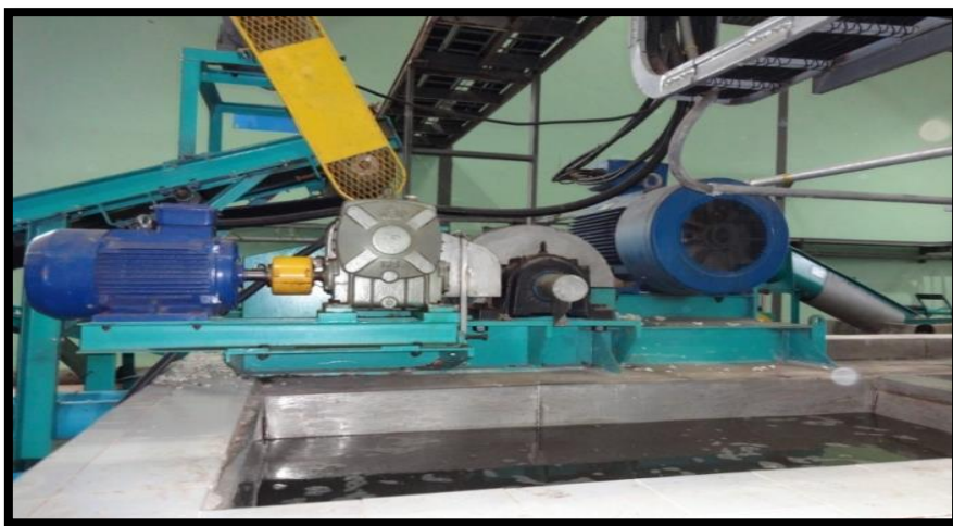
ภาพที่ 13 เครื่อง ตัด ย่อยยางก้อนถ้วยอย่างละเอียด (Final-Shredder)
